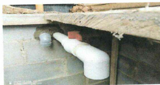
Foto # 2: Caja de lodos y líquidos.
